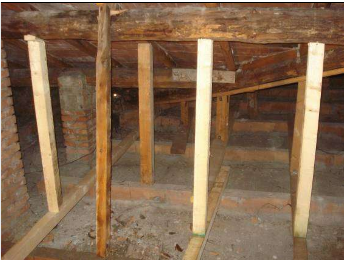
FOTO 07_foto sottotetto - stato della copertura. La presente foto è stata scattata il 9/2/2015 dopo gli interventi di messa in sicurezza: si nota la puntellatura temporanea di alcune travi.
