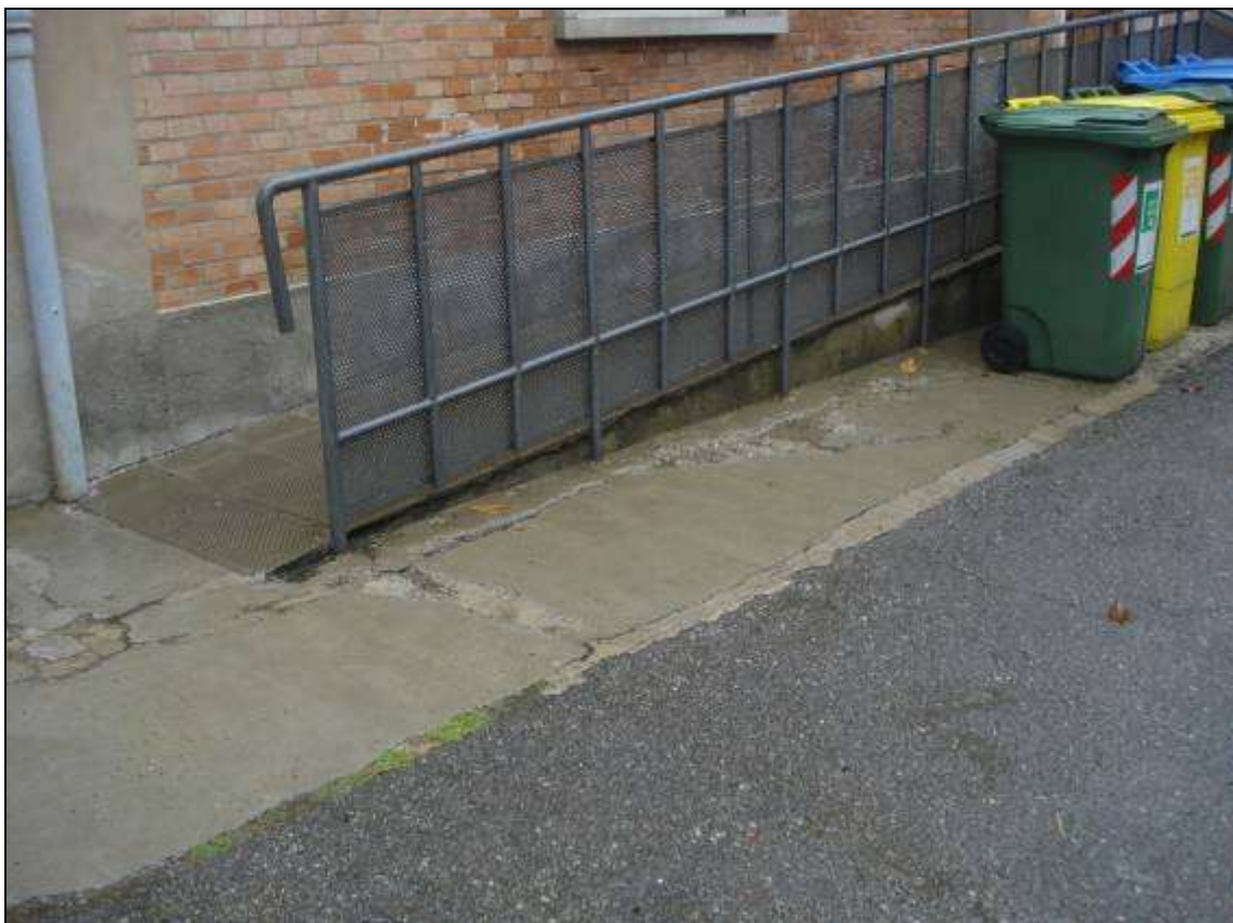
FOTO 11_Esterno, ingresso principale: marciapiede lesionato in più punti.
