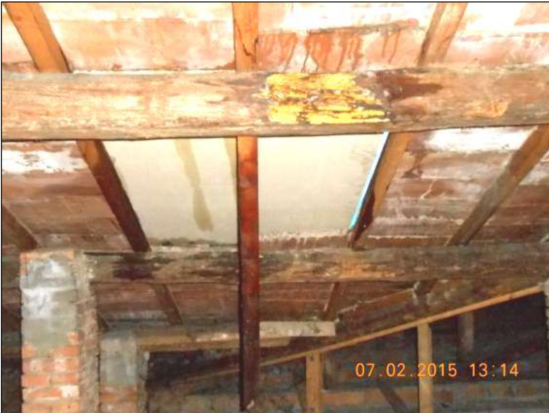
FOTO 06_foto sottotetto - stato della copertura. La presente foto è stata scattata il 7/2/2015, prima degli interventi di messa in sicurezza; si nota la porzione di solaio interessata dal cedimento (causa deposito neve). Si nota un'ingente quantità di infiltrazioni d'acqua.
