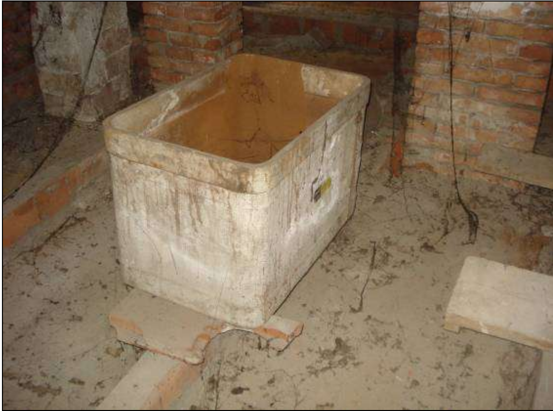
FOTO 10_foto sottotetto: vasca in eternit (dismessa). Da rimuovere a carico di ditta abilitata.
