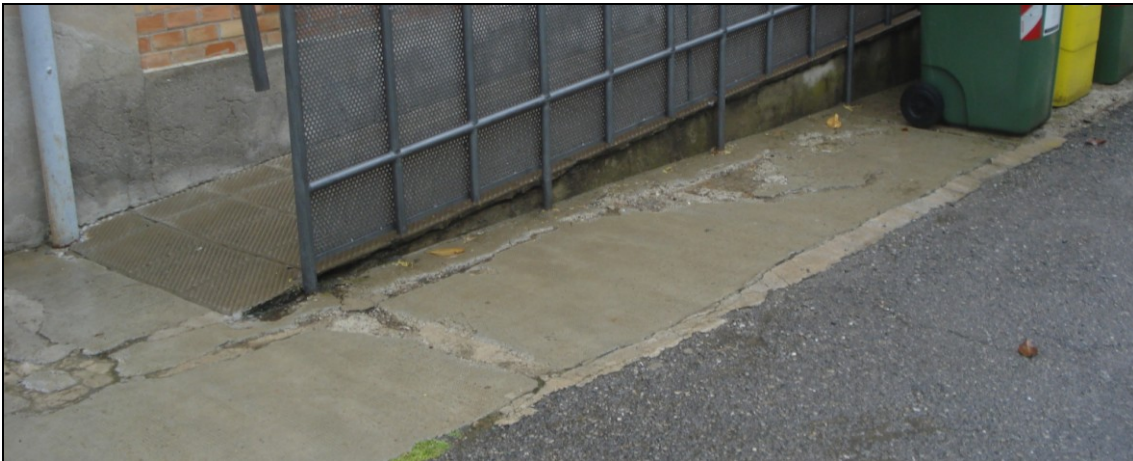
IMM09_Esterno, ingresso principale: marciapiede lesionato in più punti.
