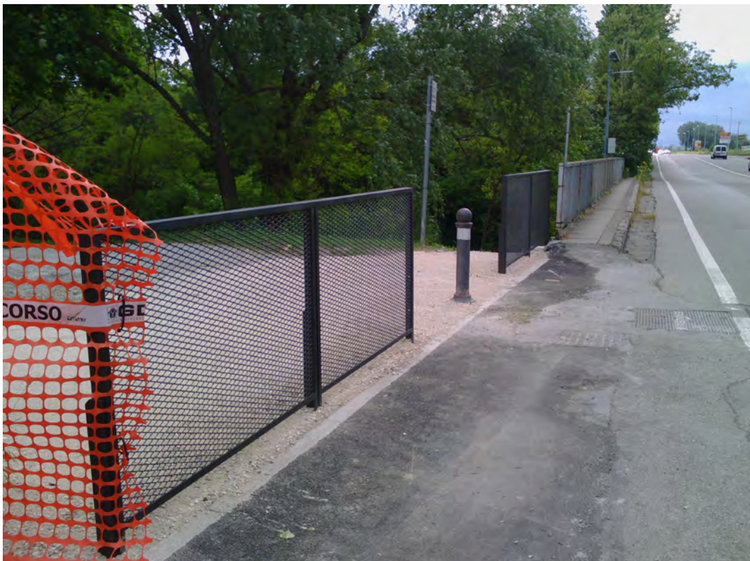
Via di Vittorio, a Castel Maggiore, in corrispondenza del ponte sul Navile, prima e durante i lavori del primo stralcio. Si nota l'assenza di apparati segnaletici indicanti la presenza del canale.
